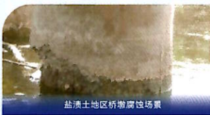
盐渍土地区桥墩腐蚀场景
