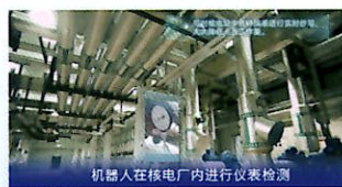
机器人在核电厂内进行仪表检测
